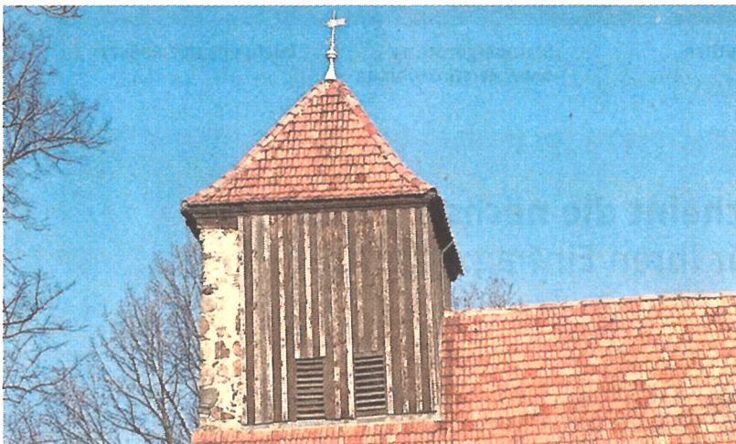
Der Turm der Dorfkirche sackt immer weiter ab.
